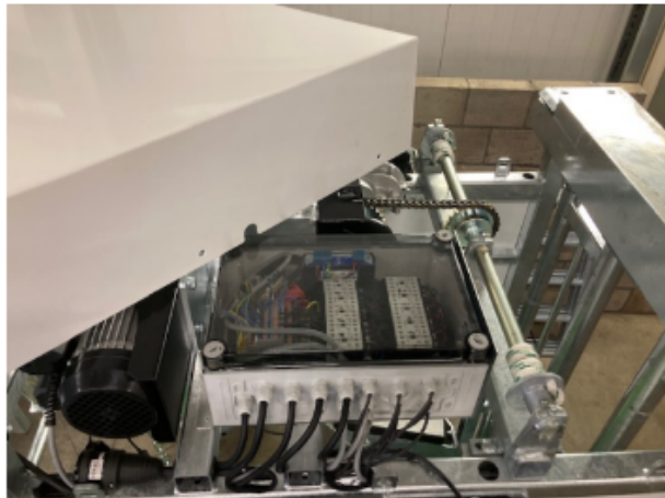
Figuur 2: schakelkast onder de top deksel.
