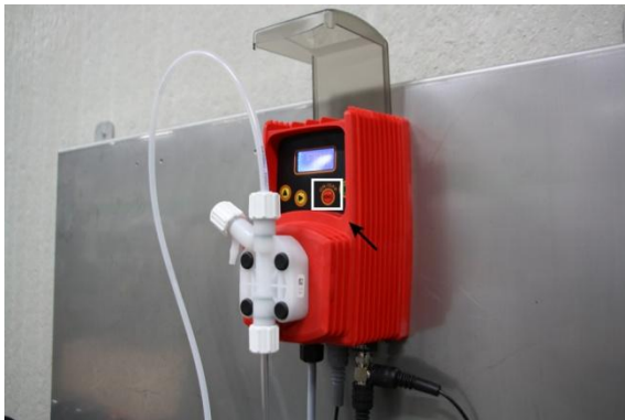
Afbeelding 12: Aanzetten van de pomp
