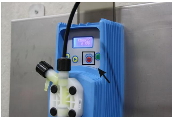
Afbeelding 5: Aanzetten van de pomp
