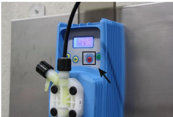
Afbeelding 9: Aanzetten van de pomp
