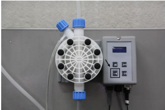
Afbeelding 13: Aanzetten van de pomp
