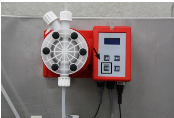
Afbeelding 5: Aanzetten van de pomp
